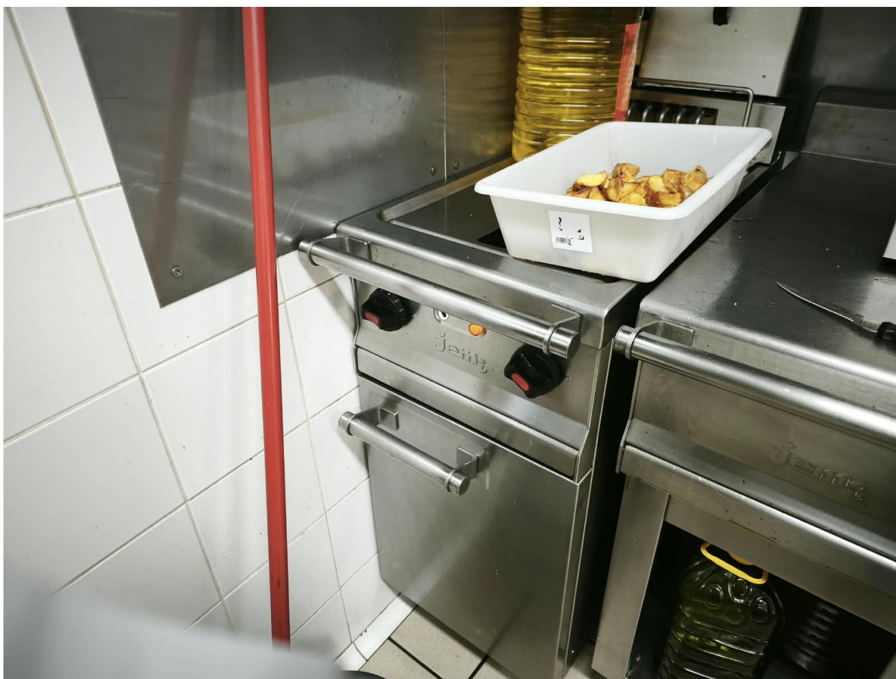
Fotografia 12. Equip de cocció de la zona de cuina.
